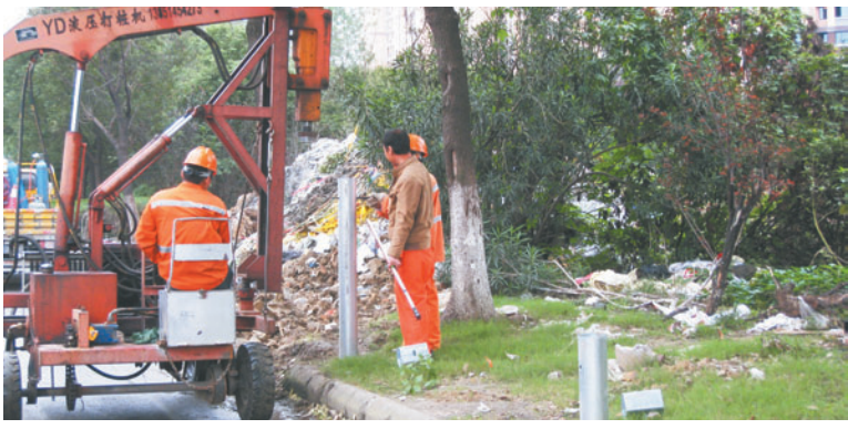
312国道武进段新龙大桥东南侧由于靠近居民区，且位置相对偏僻，一些大型渣土车经常利用夜色掩护向该处倾倒建筑垃圾。尽管公路部门多次组织清理，并安排人员不定期值守，但偷倒垃圾行为依然屡禁不止。为有效解决这一问题，武进公路处着眼长效管理，在该处设立防护栏，阻止大型车辆向该处倾倒垃圾。张焯供稿
