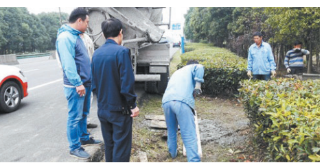
前不久，溧阳路政执法人员巡查至239省道78K+400M处时发现，右侧路边停着一辆混凝土搅拌车，操作人员竟然直接将混凝土卸载至公路边。如此违法行为，不仅对公路绿化造成损坏，侵害公路的合法权益，更存在严重交通安全隐患。执法人员当即制止了当事人的违法行为，责令其立即将公路上的混凝土清除掉，禁止搅拌车长时间停靠在公路边。张国芳供稿
