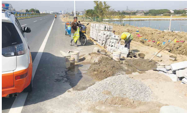
日前，在341省道别桥路段，路政执法人员在巡查时发现，某施工方将大量砖块堆放在公路边，还在路面上搅拌混凝土，严重影响公路正常通行。执法人员当即向施工方宣讲《公路安全保护条例》相关规定，责令其立即将砖块、混凝土等清除出公路，恢复了公路的整洁畅通。张国芳供稿
